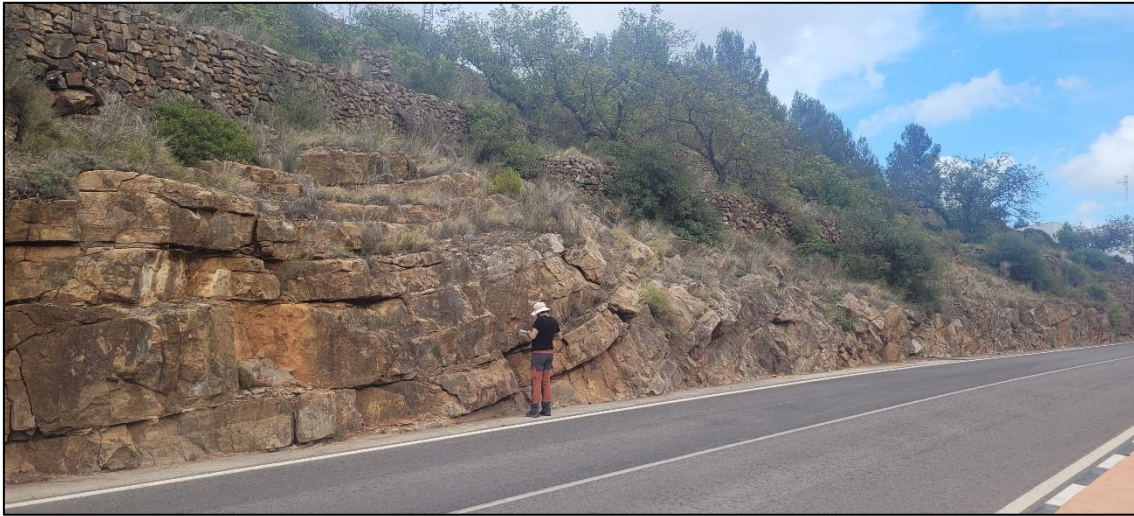
Figura 3.4. Uno de los taludes de la CV-230, donde se pueden observar las estructuras de plegamiento de las dolomías del Muschelkalk, en las que se desarrolla la cavidad
